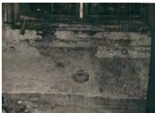
Подоконник в барабане главного купола до реставрации. 1977. АМ ДАНЛ
