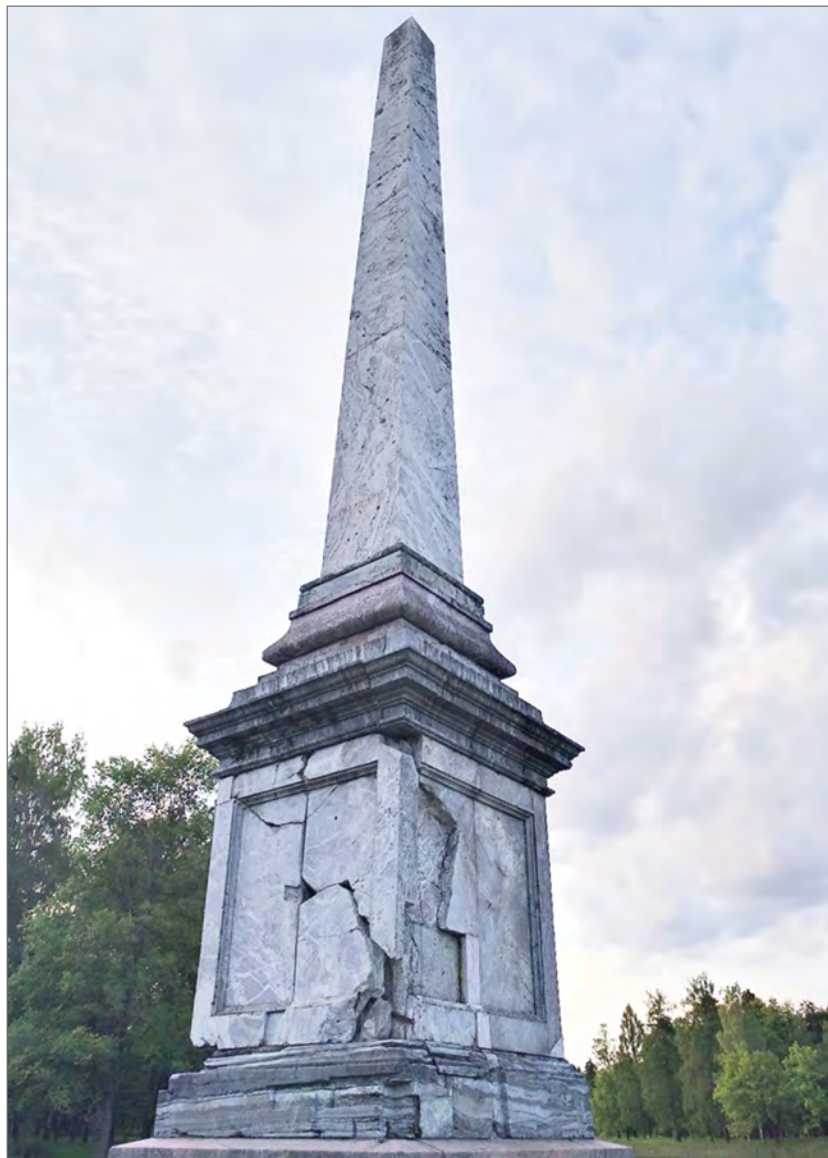
Рис. 77. Чесменский обелиск в Дворцовом парке Гатчины со следами разрушения. Фото С. А. Мозгового
