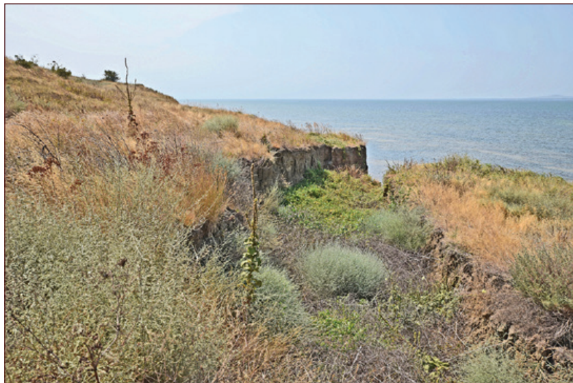
Рис. 10. Протяженная стенка отрыва оползня на побережье Таманского залива. Хорошо видно расстояние горизонтального перемещения тела оползня и амплитуда его вертикального смещения
