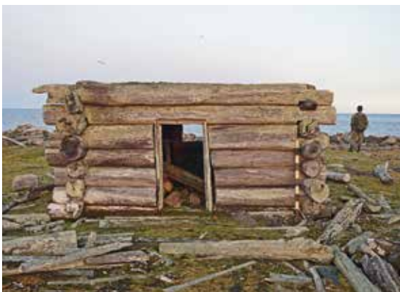
Илл. 268. Изба, вид с юго-востока. Фото П. Филин. МАКЭ, КЭ СФ, 2020 г.
