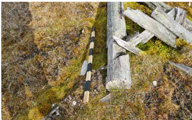
Илл. 308. Пример паза под восьмиугольный сруб. Фото П. Филин. МАКЭ, КЭ СФ, 2020 г.
