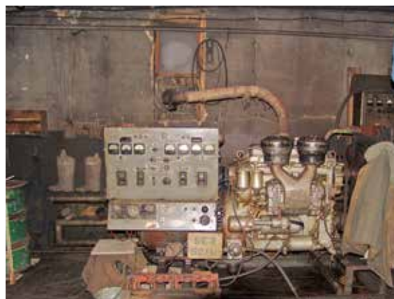
Илл. 178. Интерьер дизельной полярной станции «Остров Вилькицкого». Фото В. Н. Шумилкина. МАКЭ, 2010 г.
