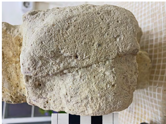
3. Трещиноватость каменного блока
