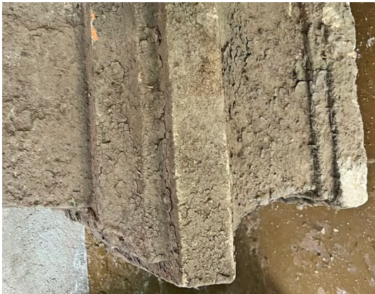
1. Шелушения красочного слоя
