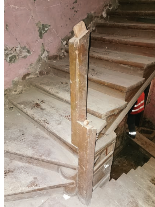
Северная лестница до реставрации
