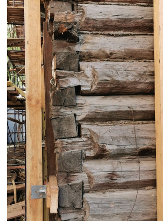
Сруб, кроме того, что сделан из не особо качественного леса, имел много деформаций и повреждений
