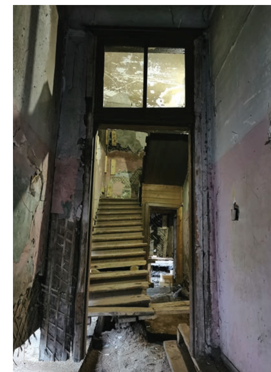
Северная лестница до реставрации
