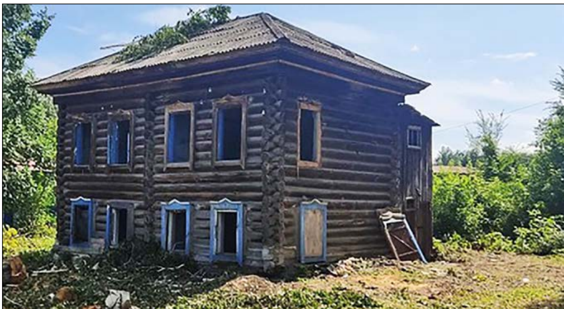
Рис. 16. Дом купца Клочкова до реставрации
