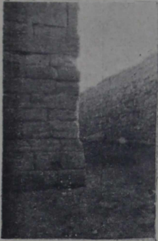
Рис. 85. Поврежденный угол 1 яруса кладки 19 куртины. Вдали протейхизма.
