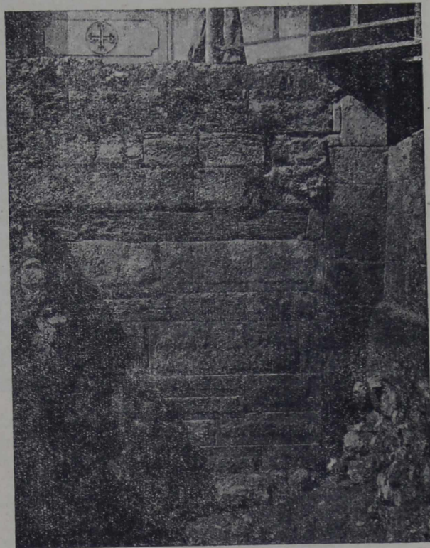
Рис. 7. Кладка конца 15 куртины, соприкасающегося с XIV башней. 1 ярус, считая снизу (6 рядов), — IV в. до н. э., выше — поздне-римская кладка. Направо — часть римской прямоугольной башни № XIV.
